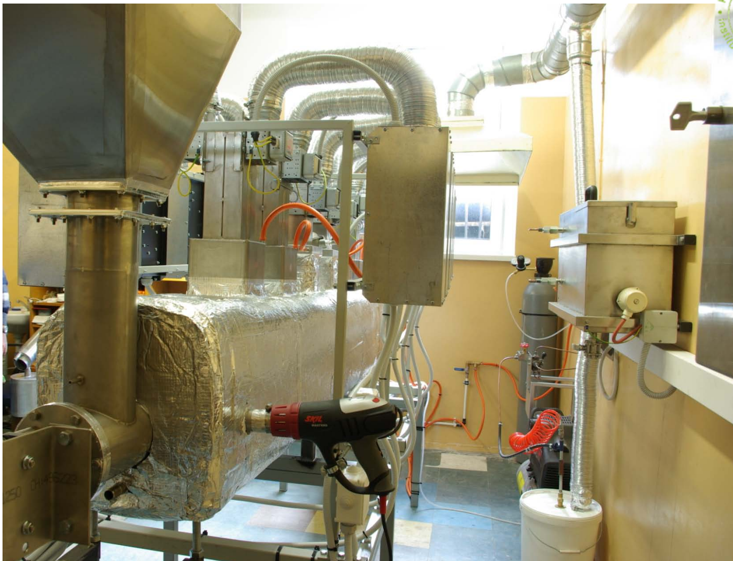
Kurināmo granulu mikroviļņu torefikācijas un tālākas šķidro energonesēju uzsmidzināšanas uz to virsmas pilotiekārtas kopskats (10,8 kW)
