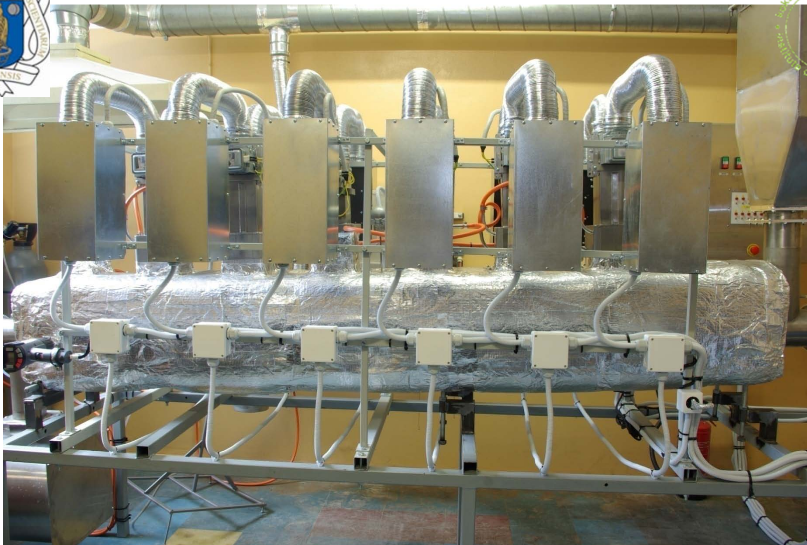
Kurināmo granulu mikroviļņu torefikācijas un tālākas šķidro energonesēju uzsmidzināšanas uz to virsmas pilotiekārtas kopskats (10,8 kW)
